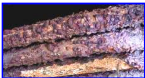
التآكل في أنابيب أحواض الطلاء.
