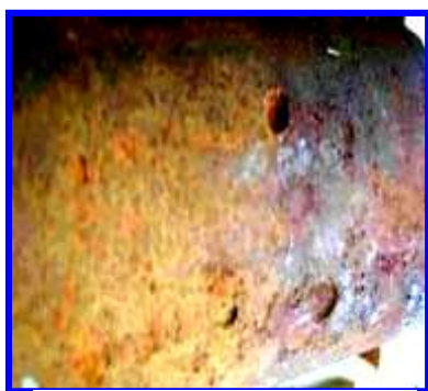
التآكل في أحواض الطلاء.
